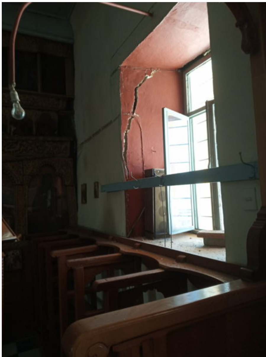
Εκτεταμένες είναι οι ρωγμές στον ναό Αγ. Νικολάου Βλάχων στον Τύρναβο. κηρυγμένο διατηρητέο μνημείο
