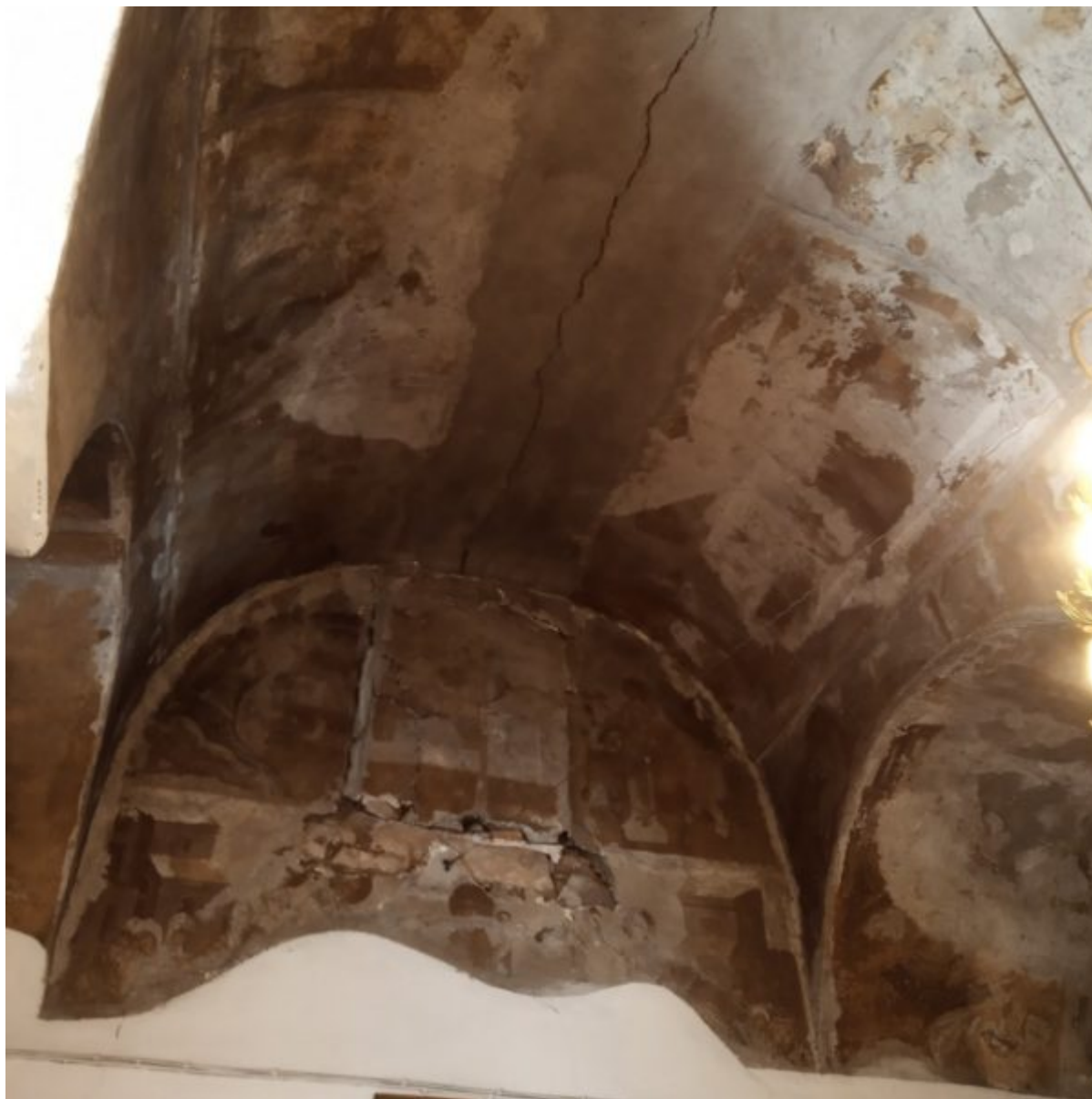
Οριζόντιο σκίσιμο στον τρούλο του Προφ. Ηλία στον Τύρναβο
