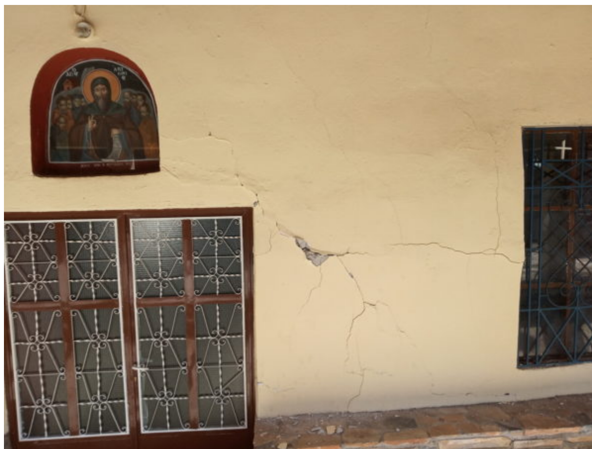
Οι ρωγμές στον Αγιο Αντώνιο Τυρνάβου, μνημείο του 1600, είναι ορατές και εξωτερικά
