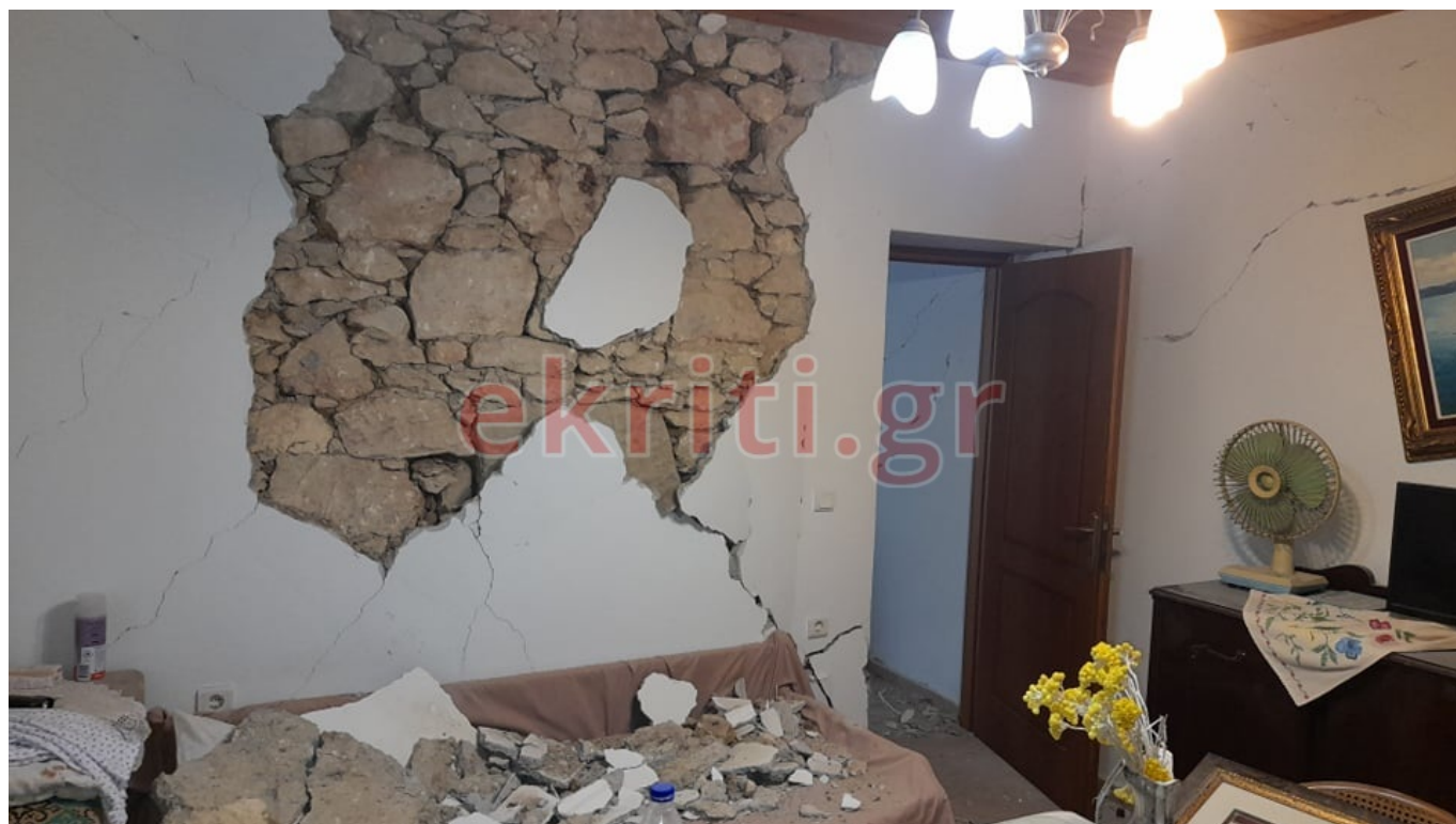
Ζημιές σε σπίτι στο Αρκαλοχώρι
