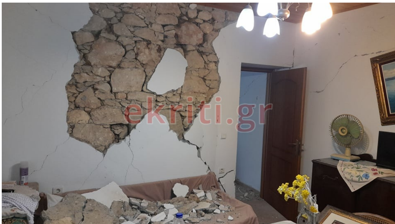
Ζημιές σε σπίτι στο Αρκαλοχώρι
