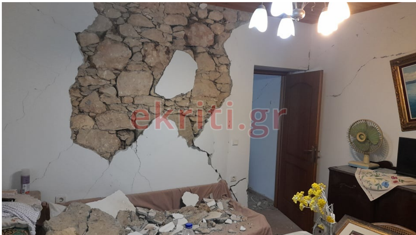
Ζημιές σε σπίτι στο Αρκαλοχώρι
