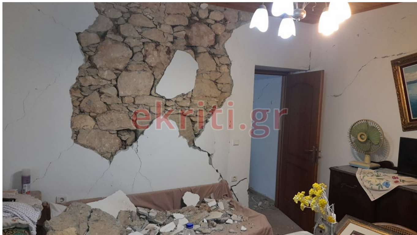
Ζημιές σε σπίτι στο Αρκαλοχώρι
